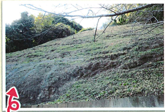
土砂崩れが起きてネットで覆った斜面(葉山第5公園)
